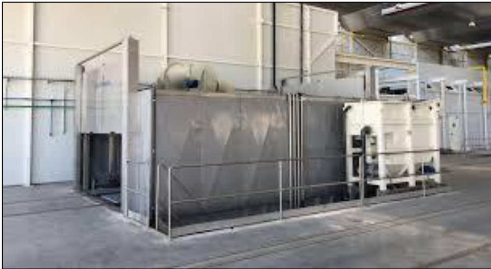
Figura 7-Cabina de lavado de bogies en España
