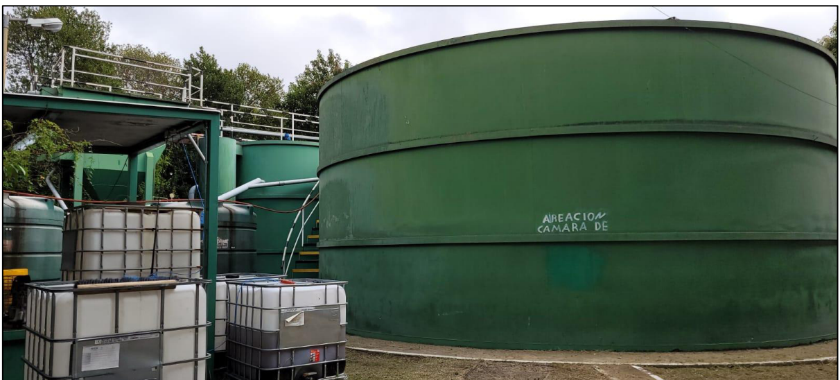
Figura 21- Centro de tratamiento de efluentes
