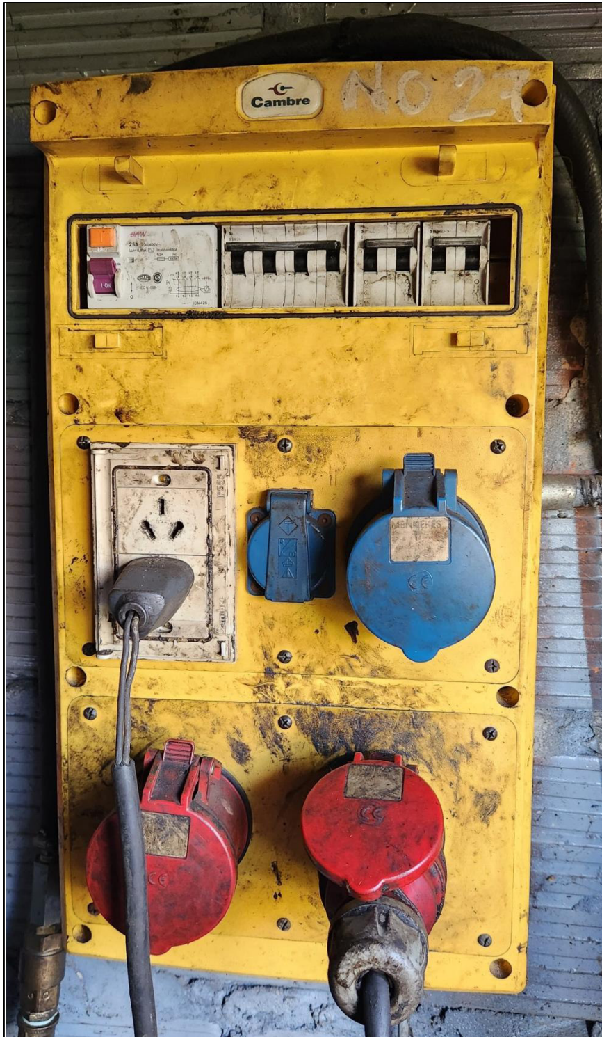
Figura 15- Tablero de hidro lavadora
