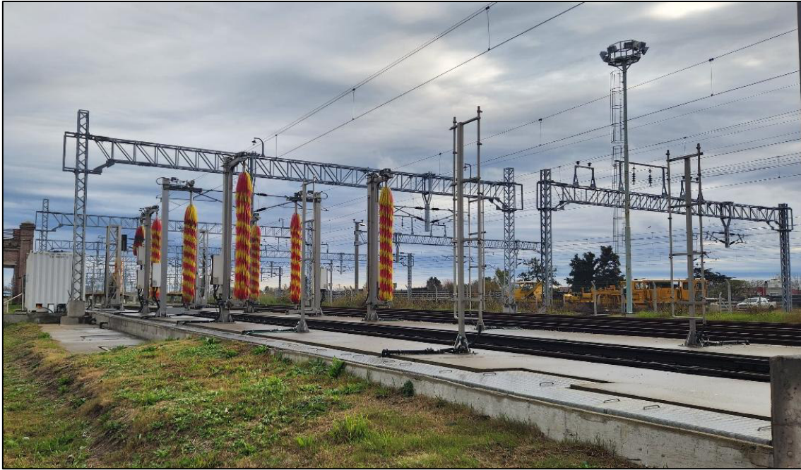
Figura 5- Túnel de lavado de coches Taller de Tolosa
