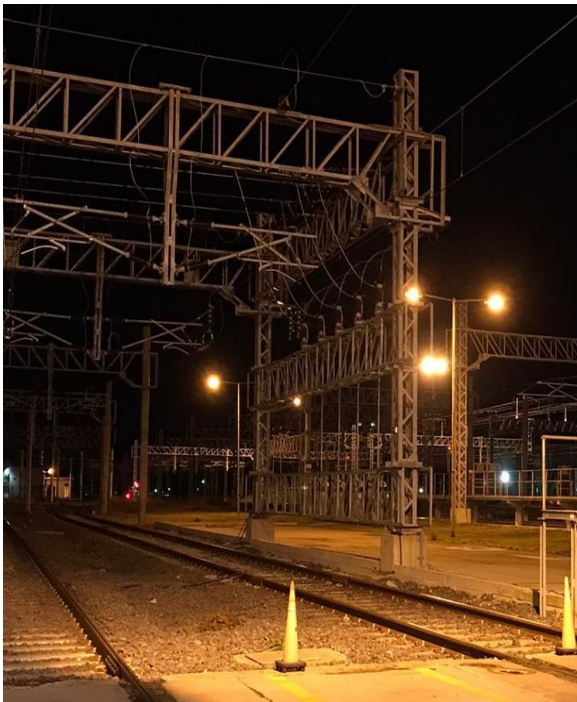
Fig. 14 – Zona de seccionadores
