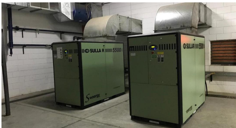
Fig. 18 – Sala de compresores
