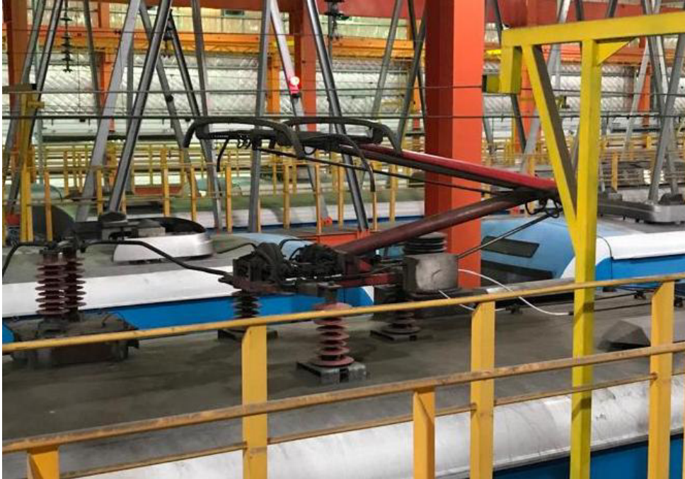
Fig. A21 – Pantógrafo en contacto con la línea catenaria
