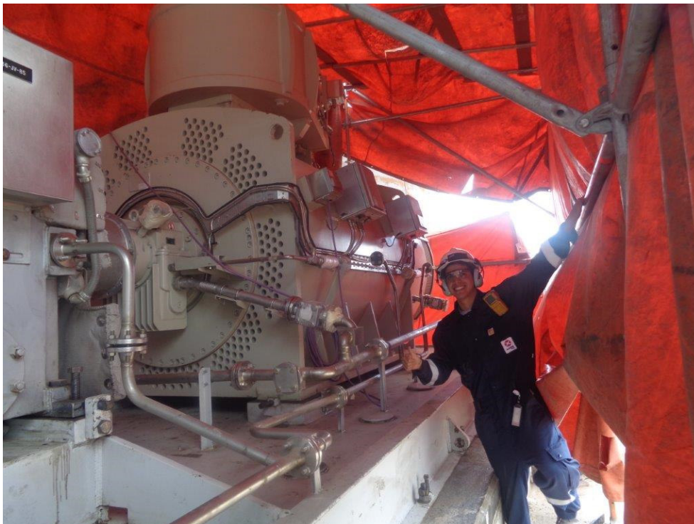
FIGURA 11 C: MOTOR DE BOMBA DE AGUA DE CORTE
