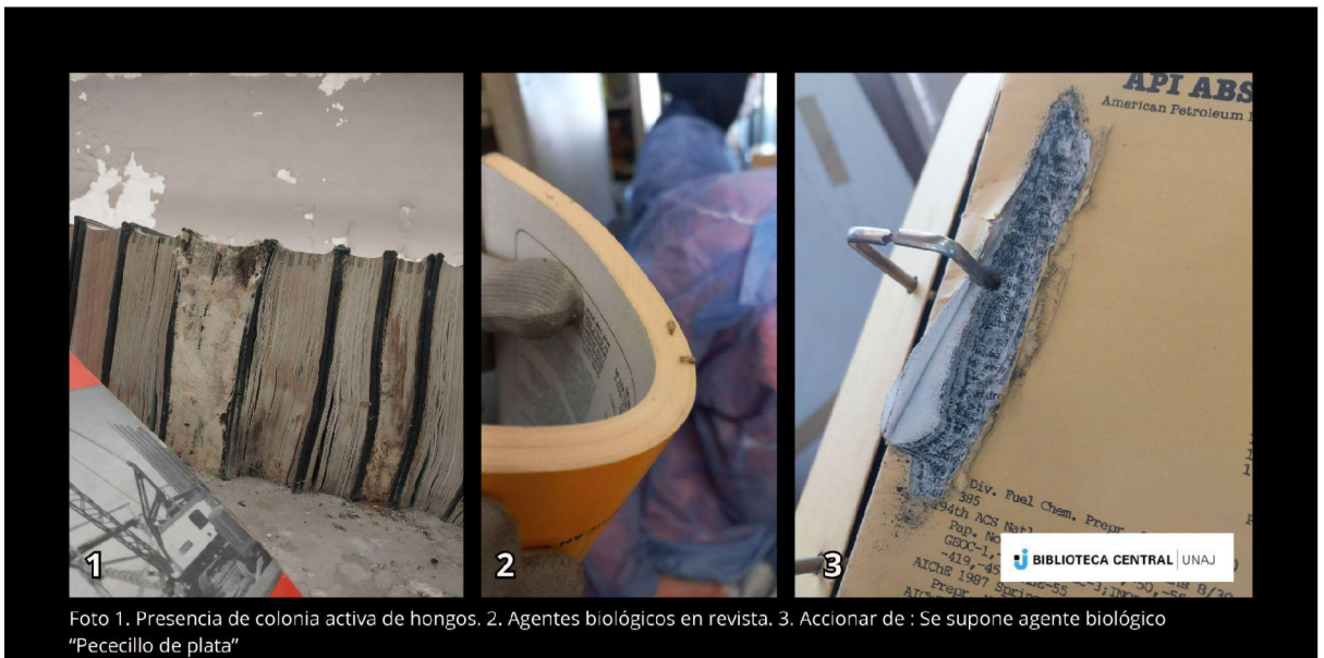
Estado del material ubicado en altura.
